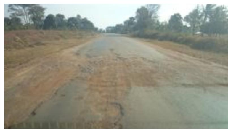
損傷した道路(東西経済回廊ラオス区間)
