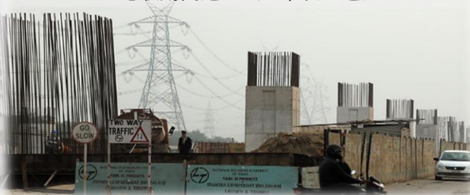
Dwarka Expressway (デリー近郊) の建設は土地収用問題により3年以上遅延
