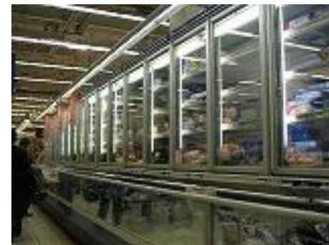
スーパーマーケットのコンビタイプ リーチイン冷凍ケース
