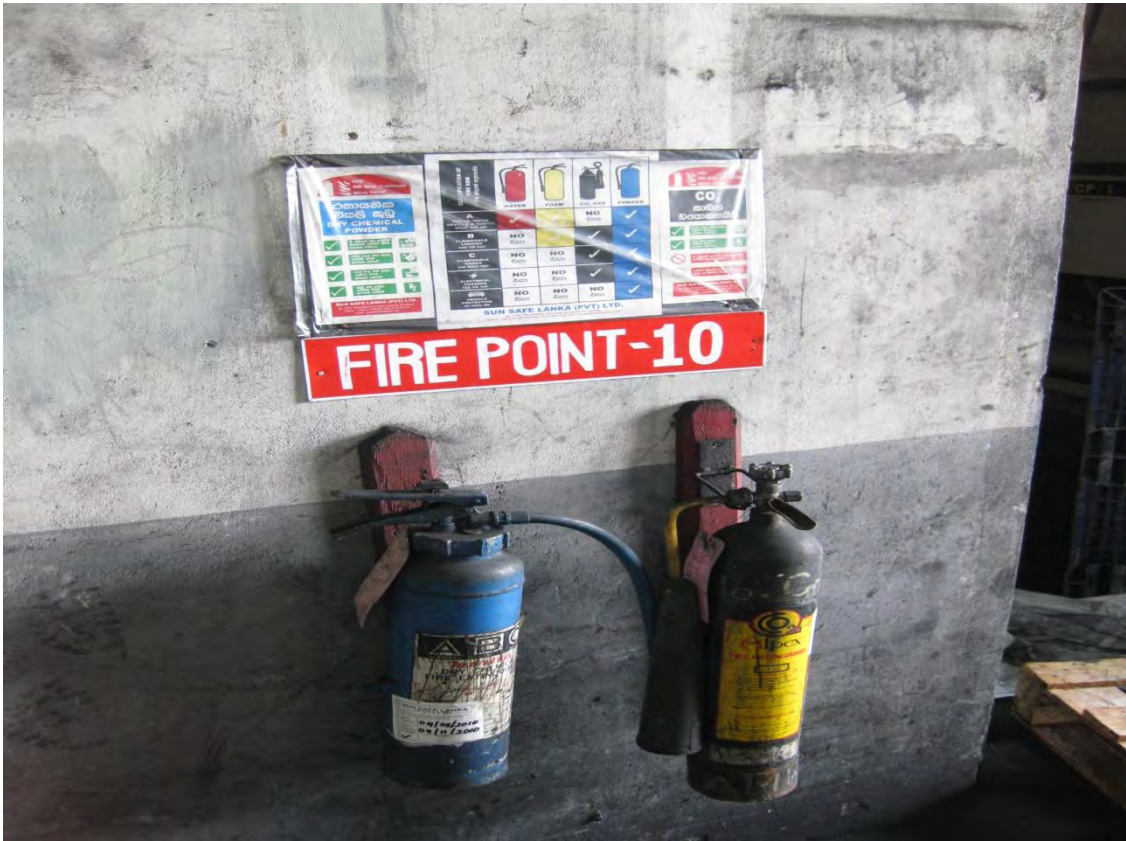
消火器設備の表示
