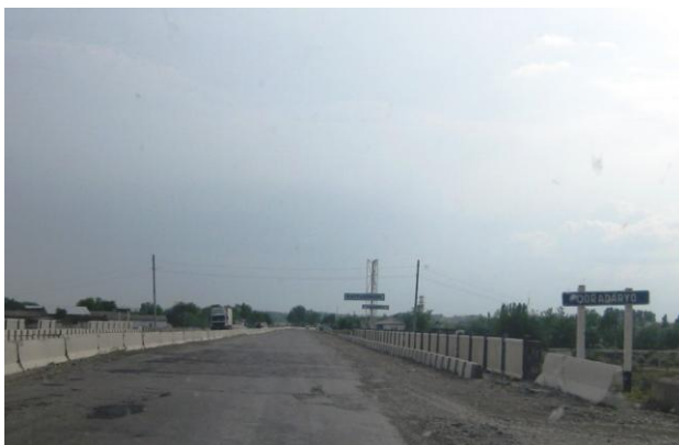
M37。舗装状態の悪い道が多い。
