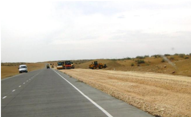
A380。ガズリ - トゥルトクリ。 完成して通行出来る道路も部分的にある。
