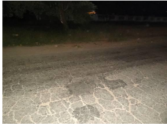
写真② 一部損傷が見られる路面
