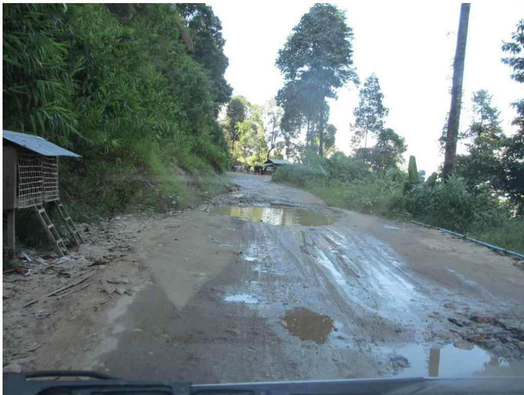
写真⑦ 劣悪な道路状況(大きな陥没)
