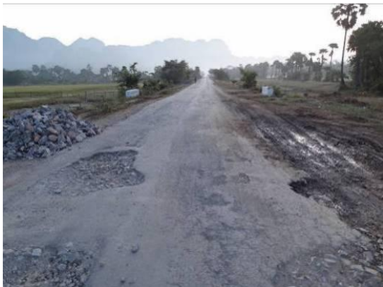
写真③ アスファルトの剥がれた道路
