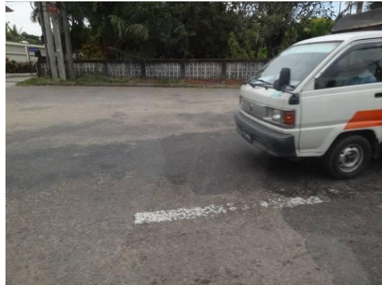
写真② バゴー周辺の路面状況
