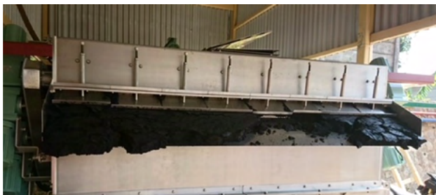
同じ東南アジアの食品工場廃水の脱水機状況 (ポリマーはMT品使用)
