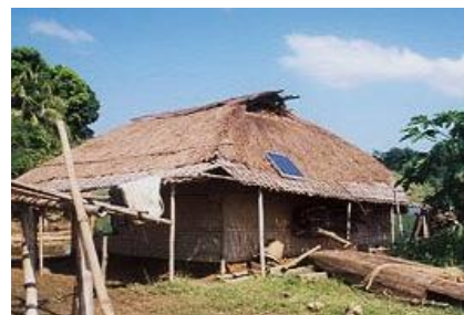
民家の屋根に設置されたソーラーパネル
