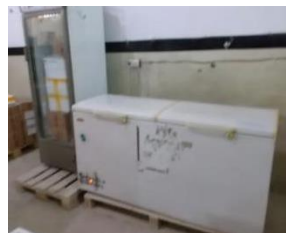
保冷材保管用冷凍庫
