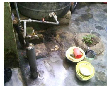
敷地内に引かれた水道の蛇口
