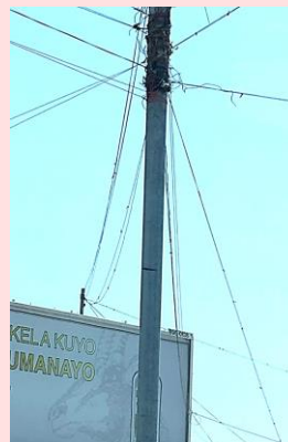
盗電用の電線が 巻きつく電柱
