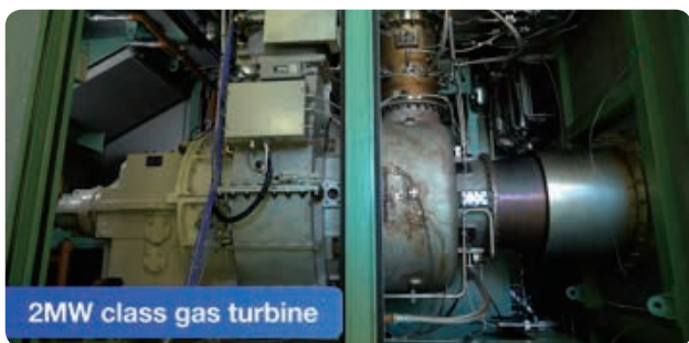
IHI 横浜事業所 2MW ガスタービン（天然ガスとの混焼実験）
